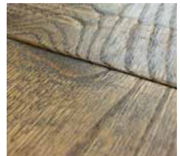
Différence de hauteur entre les lamelles
